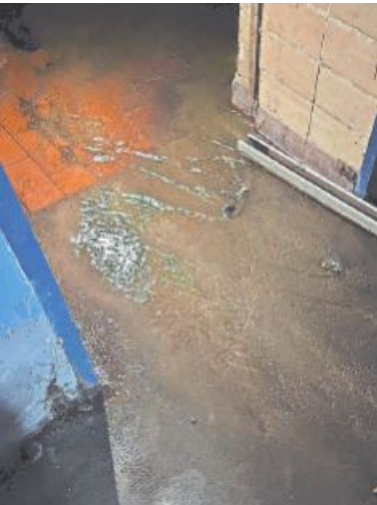
Im Keller läuft Wasser aus der Enz ins Fundament. Nicht ungewöhnlich für Lage und Alter des Gebäudes, aber ein weiterer Faktor, der eine Sanierung unwahrscheinlicher macht.
