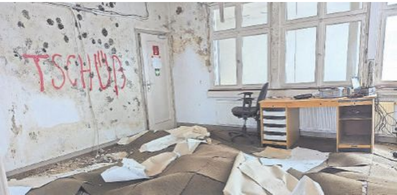
Schimmel, Verfall, Wasser im Keller: So sieht es heute im Gebäude aus. In einer Bildergalerie auf Pz-news.de gibt es noch mehr Einblicke ins Innenleben.
